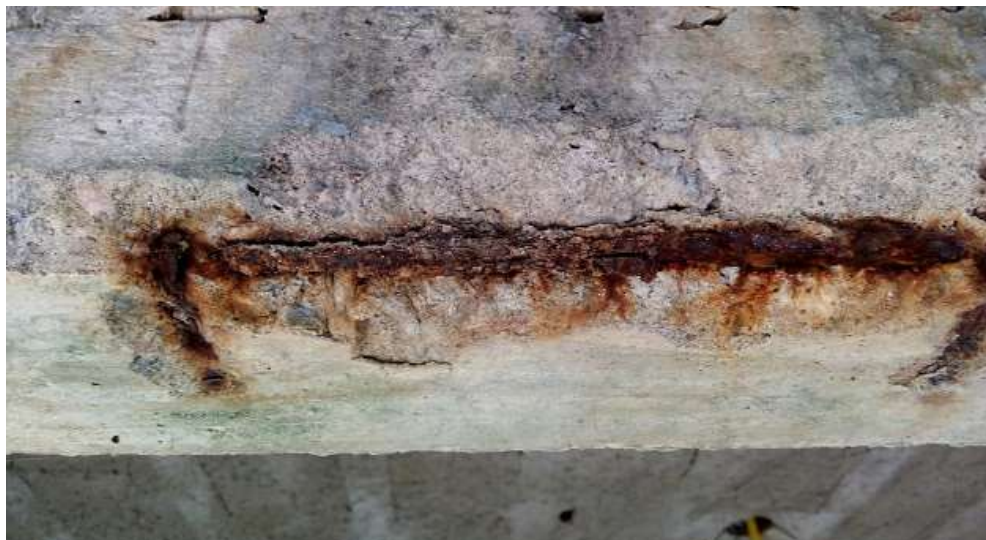
Figura 2 – Armadura em estado crítico de corrosão
