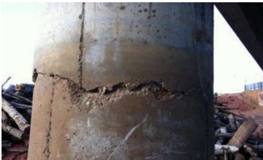
Figura 1 – Colapso de uma ponte por falha nas sustentações
