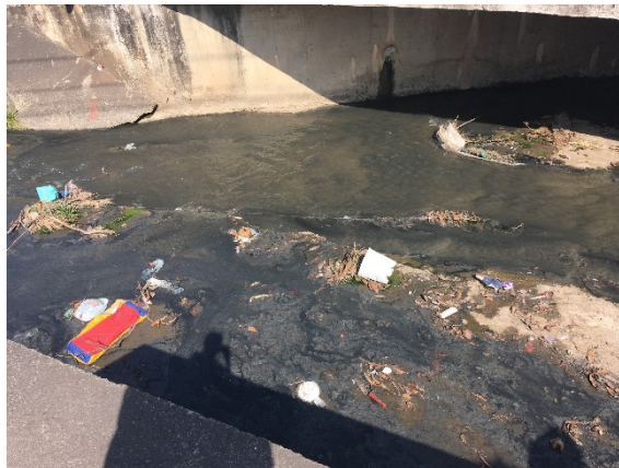
Figura 3 – Acúmulo de lixo no córrego.
