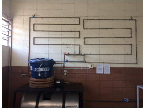
Figura 1- Bancada Hidráulica Antiga
