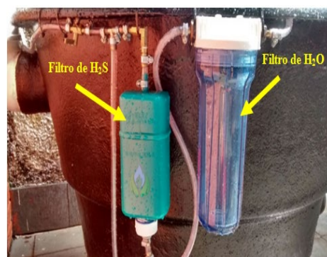
Figura 2: Protótipo biodigestor anaeróbio
