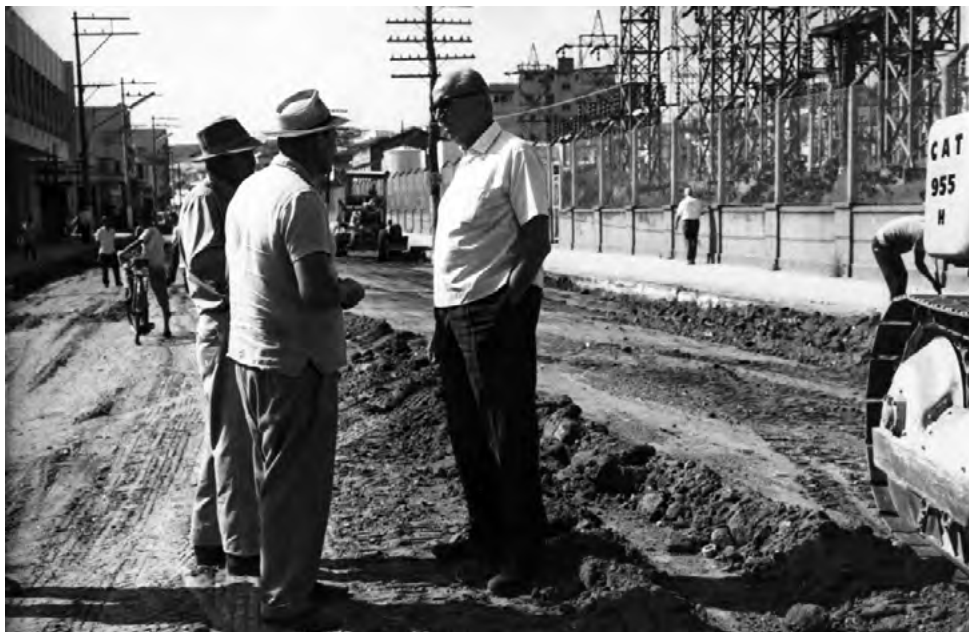
Diante das obras de canalização na Avenida Amaral Peixoto, Savio Gama conversa com os operários e transeuntes.
